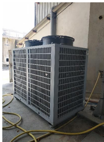
Photo n° 8 : Groupe froid vinification
