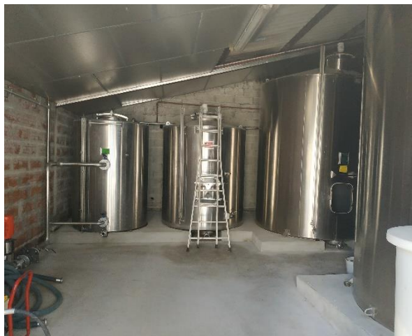
Photo n° 6 : Cuves inox du chai de distillation
