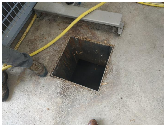
Photo n° 13 : cuve à vinasses enterrée de 11 m 3
