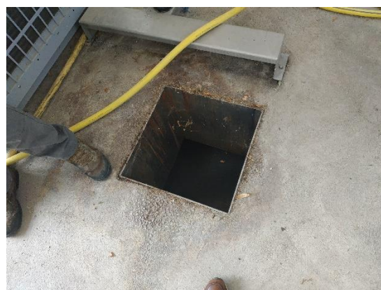
Photo n° 5 : Fosse à vinasse et rétention
