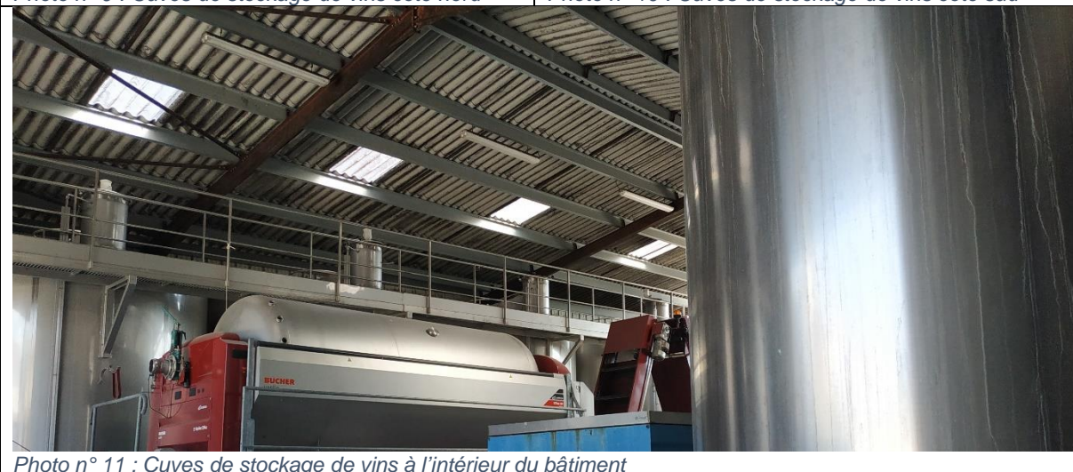
Photo n° 11 : Cuves de stockage de vins à l'intérieur du bâtiment
