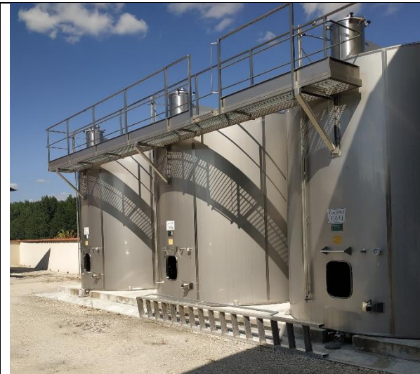
Photo n° 9 : Cuves de stockage de vins côté nord
