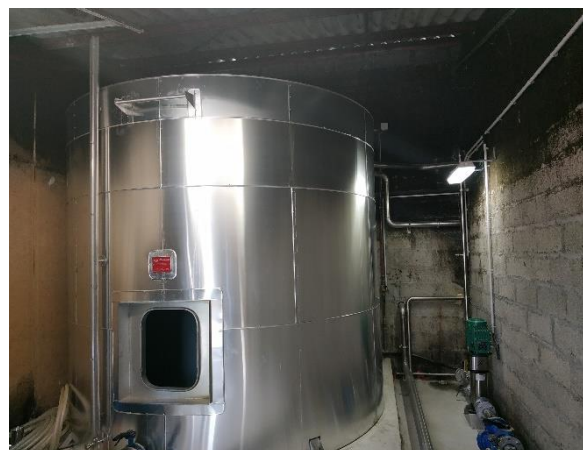
Photo n° 3 : Cuve eau chaude
