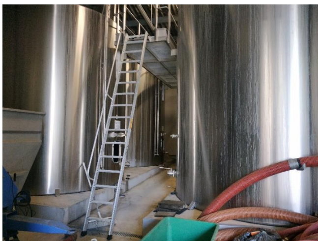
Photo n° 7 : Cuves inox du chai de vinification
